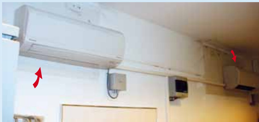
Daikin-Redundanzanlage, Sitzmöbelfabrik Spahn, Stadtlohn
