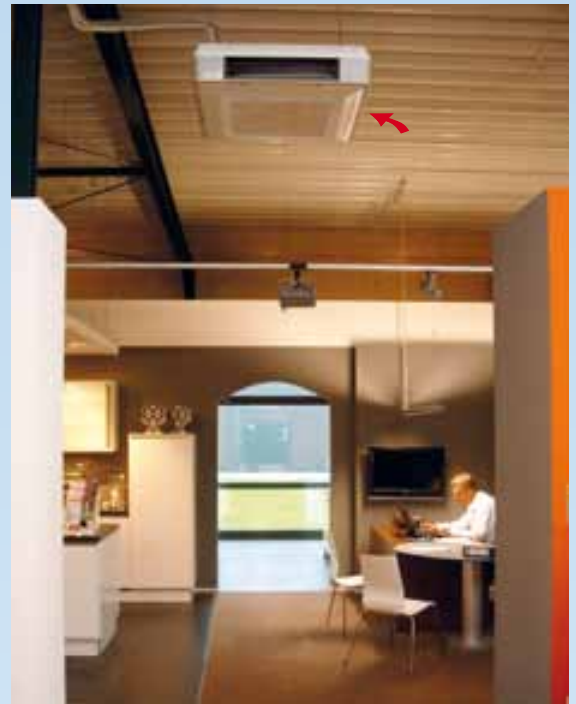
Keitmeier, Stadtlohn: Ausstellung mit ca. 4 m Deckenhöhe. Installiert wurden 4-seitig ausblasende Unterdeckengeräte
