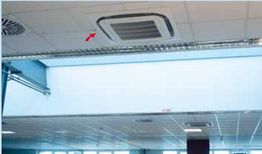
Metrica Interior, Senden: Großraumbüro mit insgesamt 4 Round-Flow Kassetten und 2 Außengeräte (Gesamtkühlleistung 20 kW). Alle Innengeräte und damit auch die Außengeräte lassen sich über eine Kabelfernbedienung regeln.
